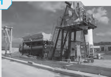
1 Centrale à béton
