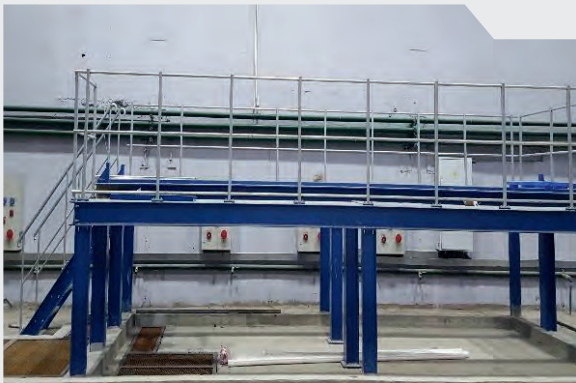
Plateforme de maintenance
