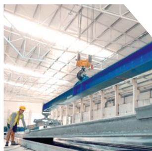
Équipement de levage
